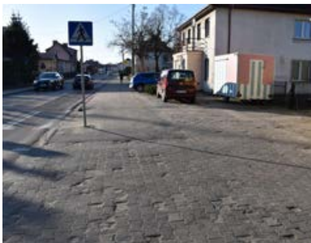
Część miejsc parkingowych przy drodze wojewódzkiej nr 209 w Kołczygłowie zostanie zlikwidowana w momencie, gdy droga będzie modernizowana
