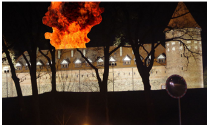
Według niektórych fachowców klimatyzacja zamontowana nad zamkowym hotelem może grozić nawet wybuchem
