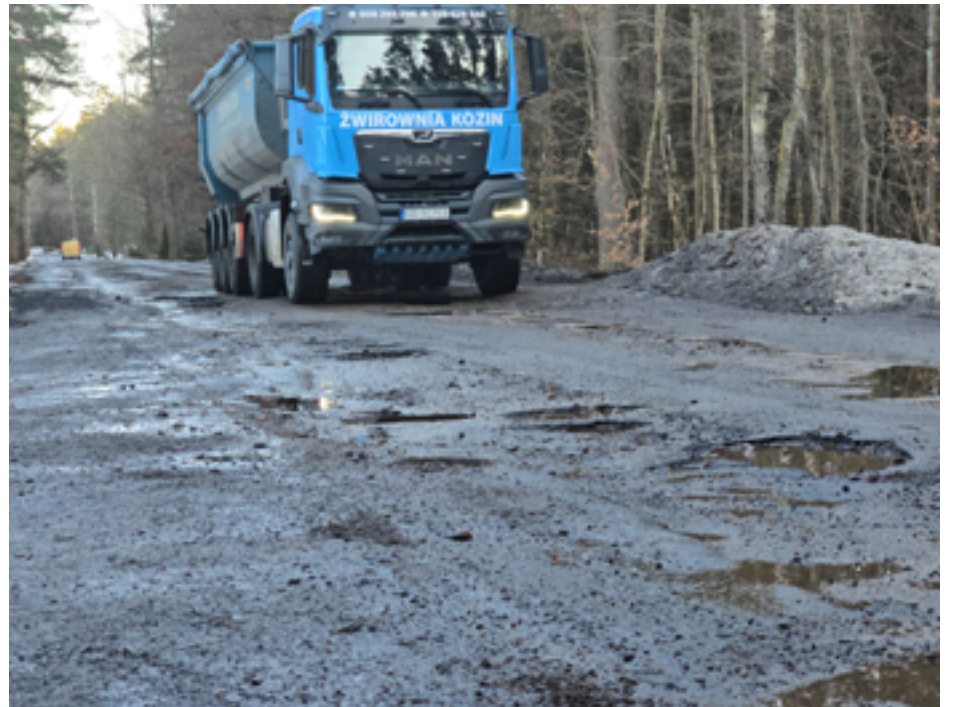
W takim stanie po zimie jest droga powiatowa z Podkomorzyc w kierunku Gogolewa
